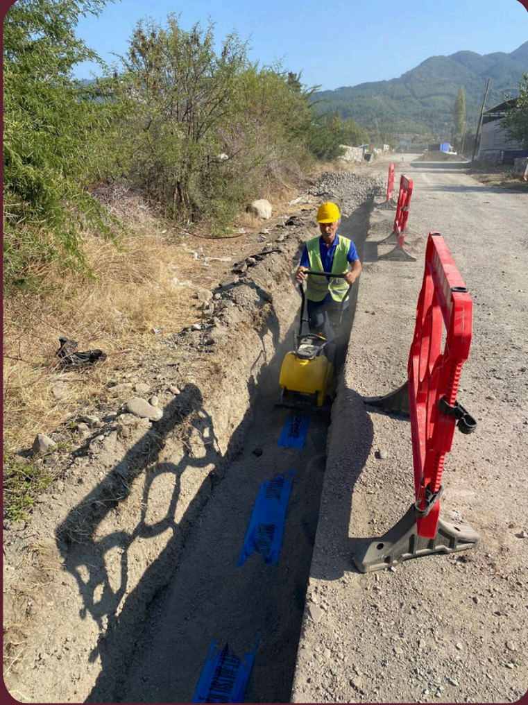
Hatay Dört yol - İçmesuyu hattı
