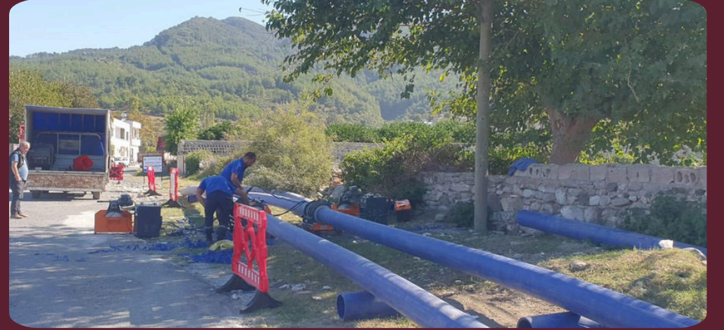
Hatay Dört yol · İçmesuyu hattı
