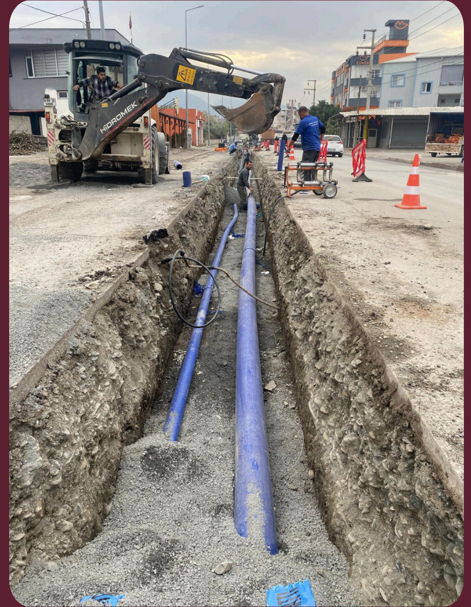
Hatay Dört yol · İçmesuyu şebekesi
