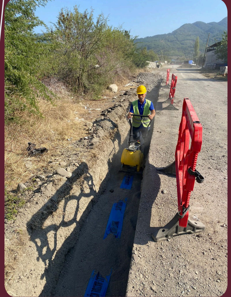
Hatay Dört Yol - İçmesuyu hattı
